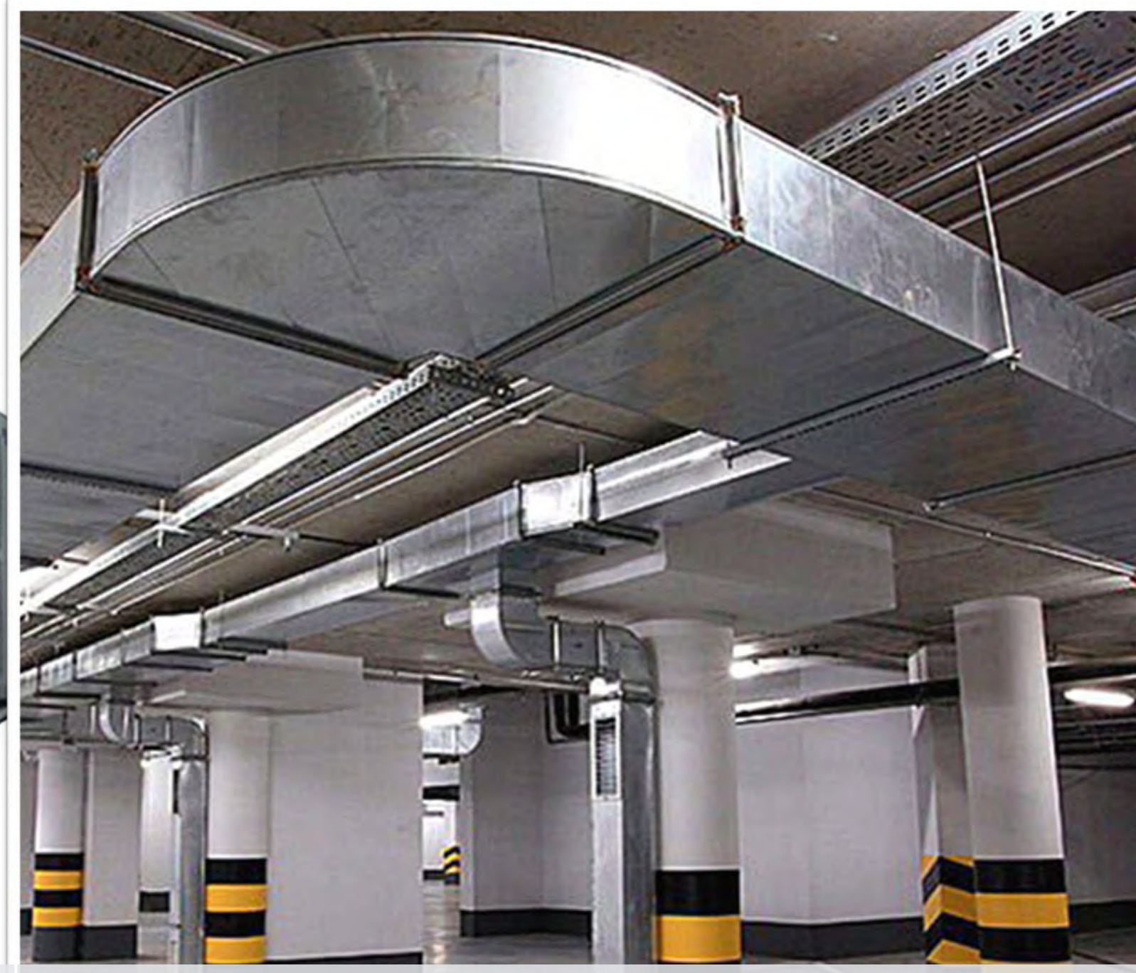
Havalandırma hatları Havalandırma kanalı, galvaniz kanal, dkp sac kanal, sipro kanal
